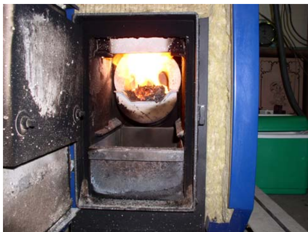
Obr. 1: Pohled do spalovací komory při spalování dřevních peletek
