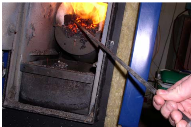
Obr. 2: Pohled do spalovací komory při spalování peletek z tritikale
